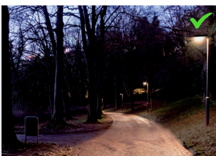
Neuanlage mit gleichmäßiger LED Wegebeleuchtung
