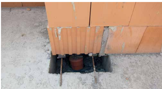
Schwierigkeit: nachträglicher gas- und dampfdichter Verschluss
