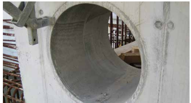
FZR400/300 Einbauort Kläranlage
